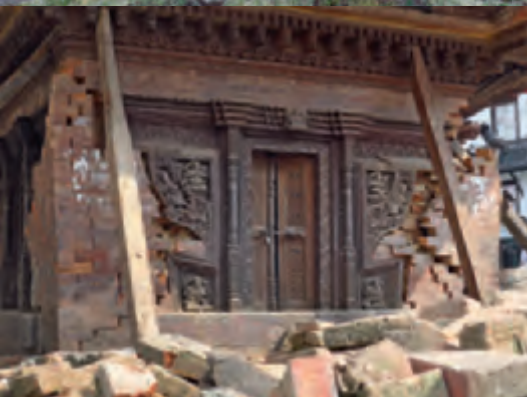
Einsturzgefährdeter Tempel in Kathmandu
